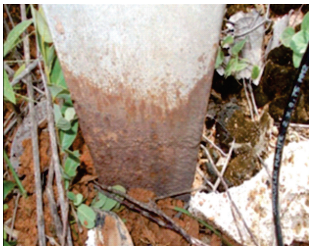
Figura 4 – Ocorrência de corrosão por aeração diferencial observado em um montante de uma das torres inspecionadas em dezembro de 2012.
