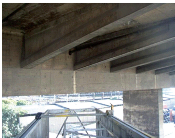
Figura 3 – Vistoria das transversinas do eixo 388/389.
