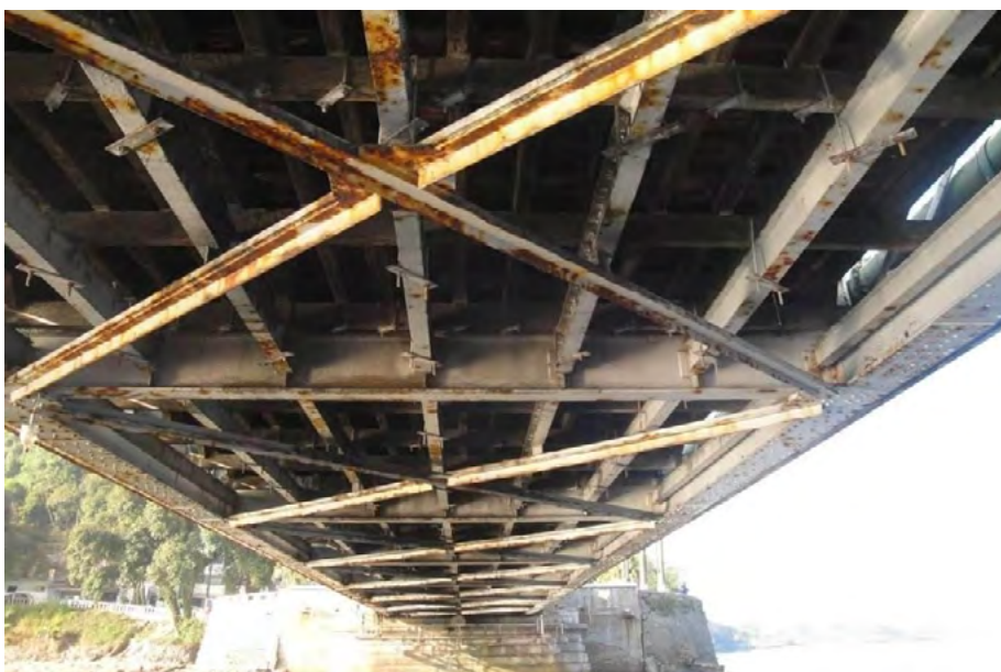
Figura 7 – Vista inferior do tabuleiro metálico com elementos corroídos.
