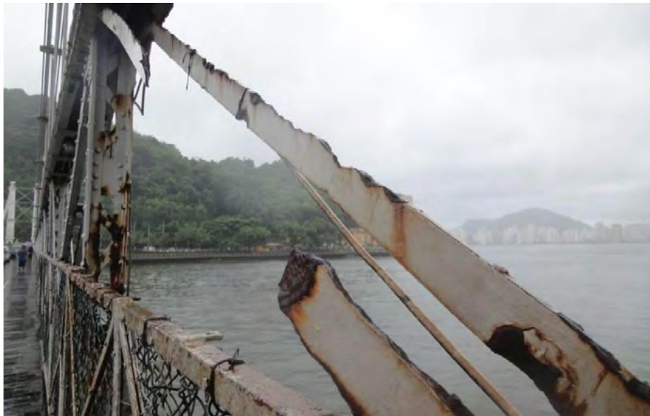
Figura 6 – Vista da treliça de rigidez com elementos metálicos corroídos, inclusive com perda de seção.
