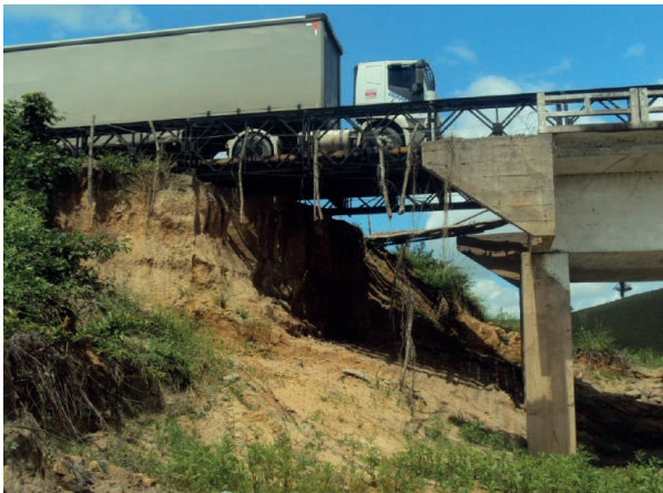
Figura 10 – Aterro destruído e ponte provisória em um lado da ponte (Fonte: VITÓRIO, 2015).
