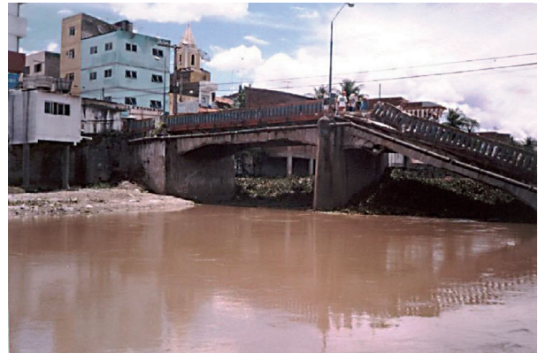
Figura 9 – Desabamento do vão apoiado no encontro danificado (Fonte: VITÓRIO, 2007).
