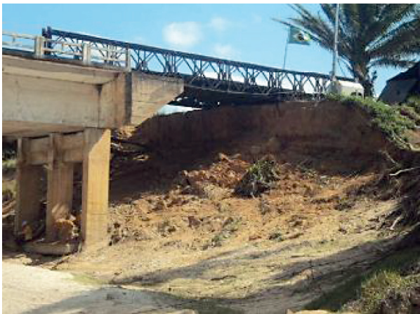
Figura 11 – Aterro destruído e ponte provisória no outro lado da ponte (Fonte: VITÓRIO, 2015).
