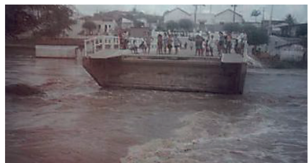
Figura 14 – Destruição total dos aterros de acesso durante uma cheia (Fonte: VITÓRIO, 2007).
