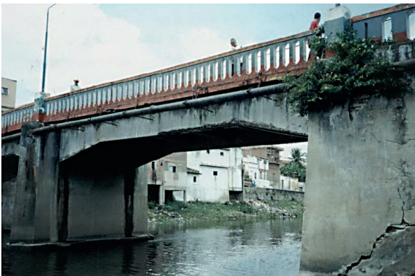
Figura 8 – Situação geral da ponte com grandes danos em um dos encontros (Fonte: VITÓRIO, 2007).
