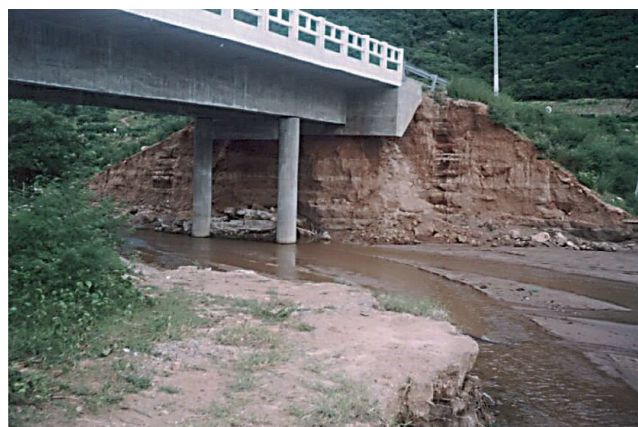
Figura 4 – Destruição causada pela erosão nas saias do aterro de acesso de uma ponte (Fonte: VITÓRIO, 2015).
