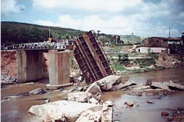
Figura 7 – O que restou da ponte após a ruptura estrutural (Fonte: VITÓRIO, 2007).
