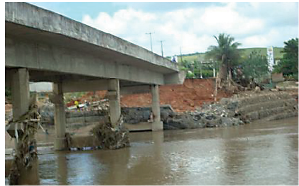
Figura 12 – Destruição dos aterros e retenção de material sólido nos pilares (Fonte: VITÓRIO, 2015).
