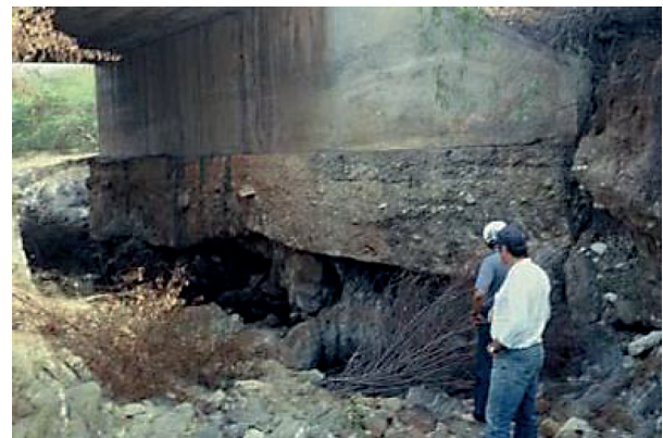
Figura 6 – Grande erosão na fundação do encontro (Fonte: VITÓRIO, 2007).
